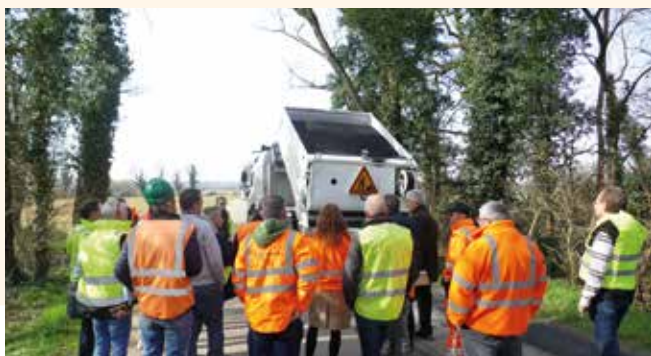
Démonstration d'enrobé projeté et de pontage de fissures en présence d'élus, d'agents des communes et des maîtres d'œuvre.
